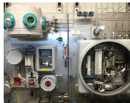
Intérieur du poste d'injection
